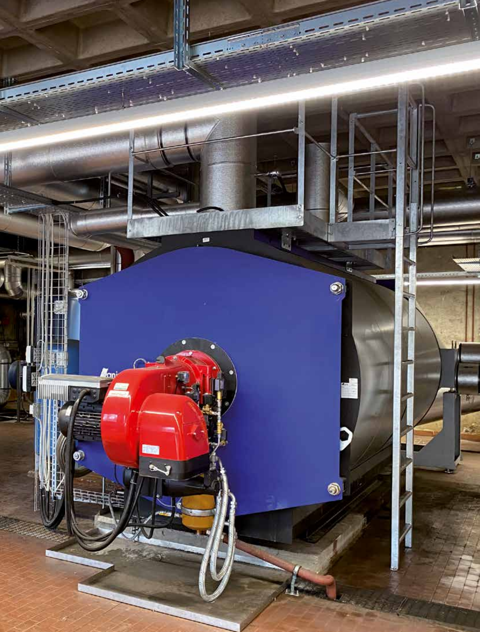
Nouvelle chaudière installée en 2019 dans la chaufferie de Cité-Ouest
