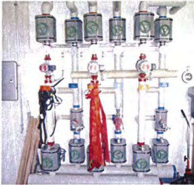
Collecteur de la sous-station du bâtiment des pompiers
