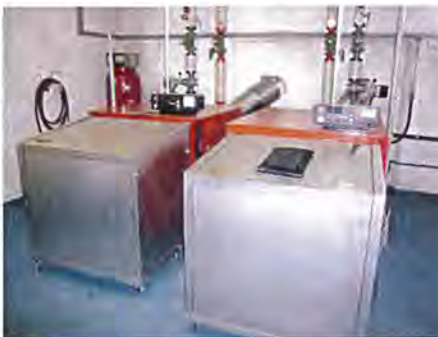
Chaudières Strebel 1 (gauche) et 2 (droite)
