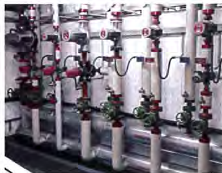
Collecteur principal (chaufferie, bâtiment existant)
