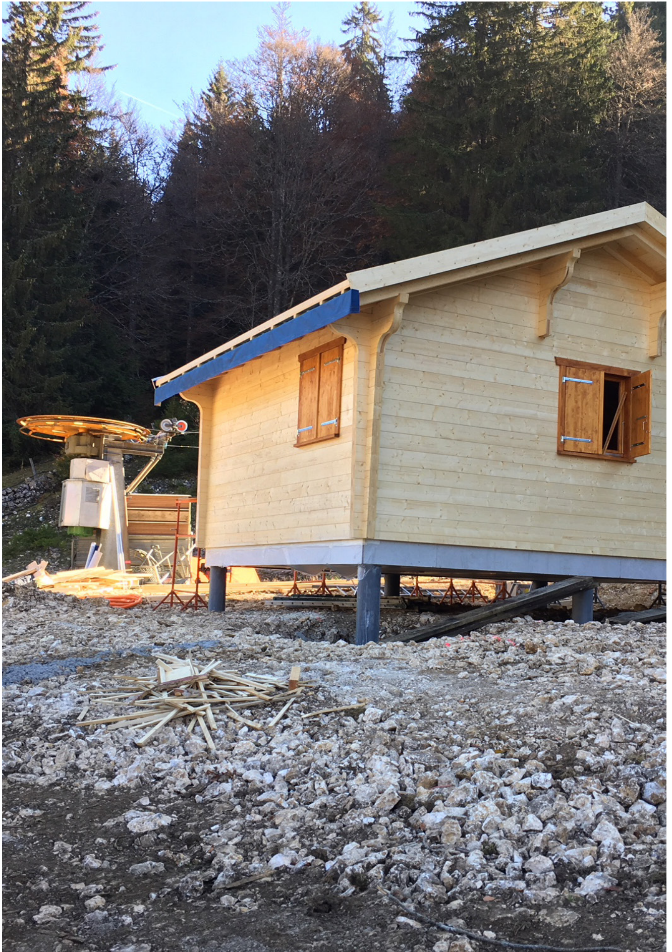
Installation en octobre du nouveau petit chalet en bois suisse pour le télésiège Télé-Dôle du Tabagnoz, au pied de la Dôle.
