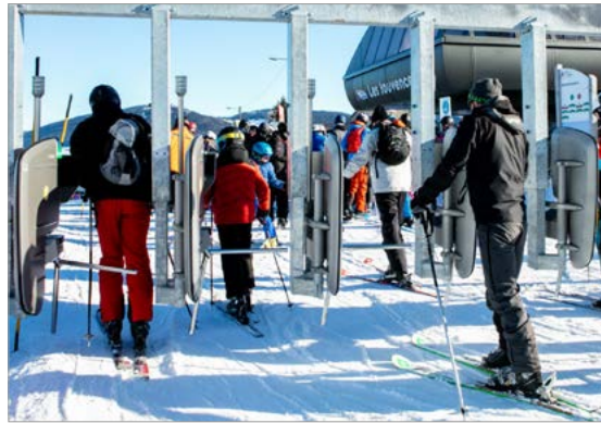
Des portiques mains-libres ont été installés à Jura sur Léman.
