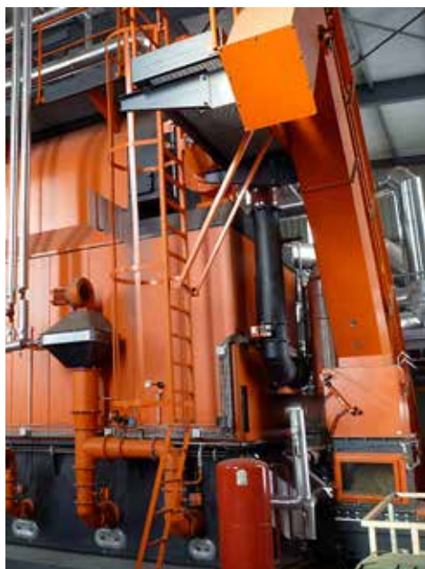
Chauffage à distance à l'image de celui d'Avenches
